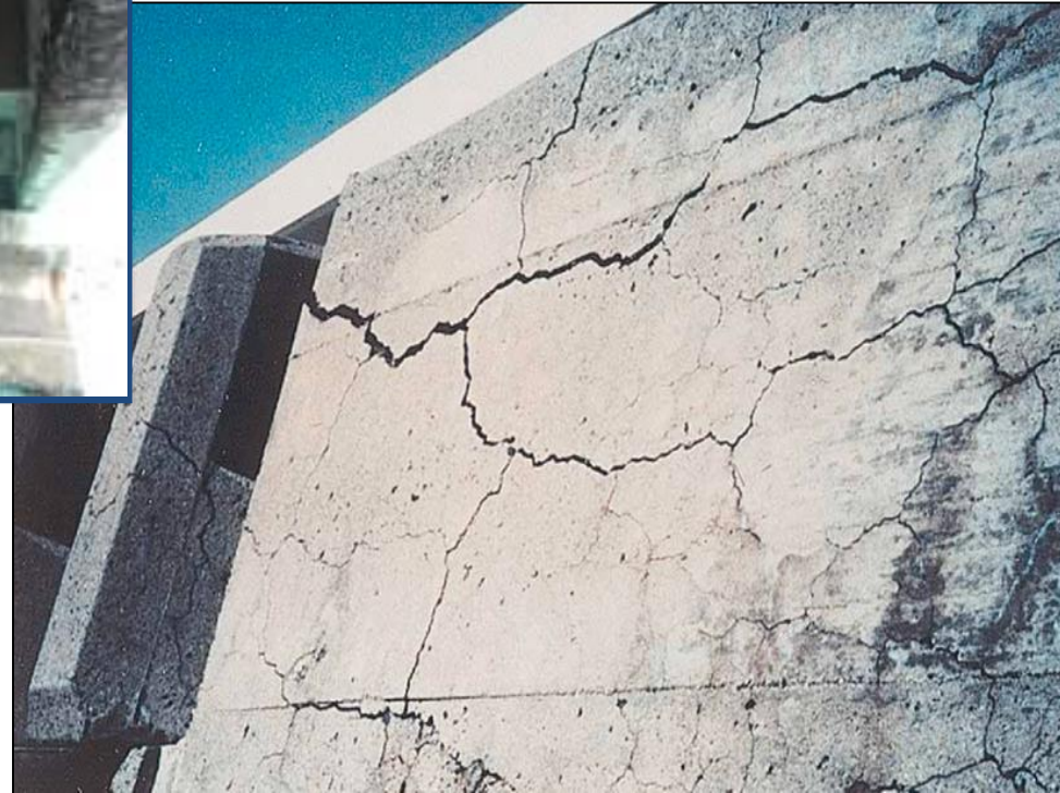
アルカリ骨材反応によるひび割れ
