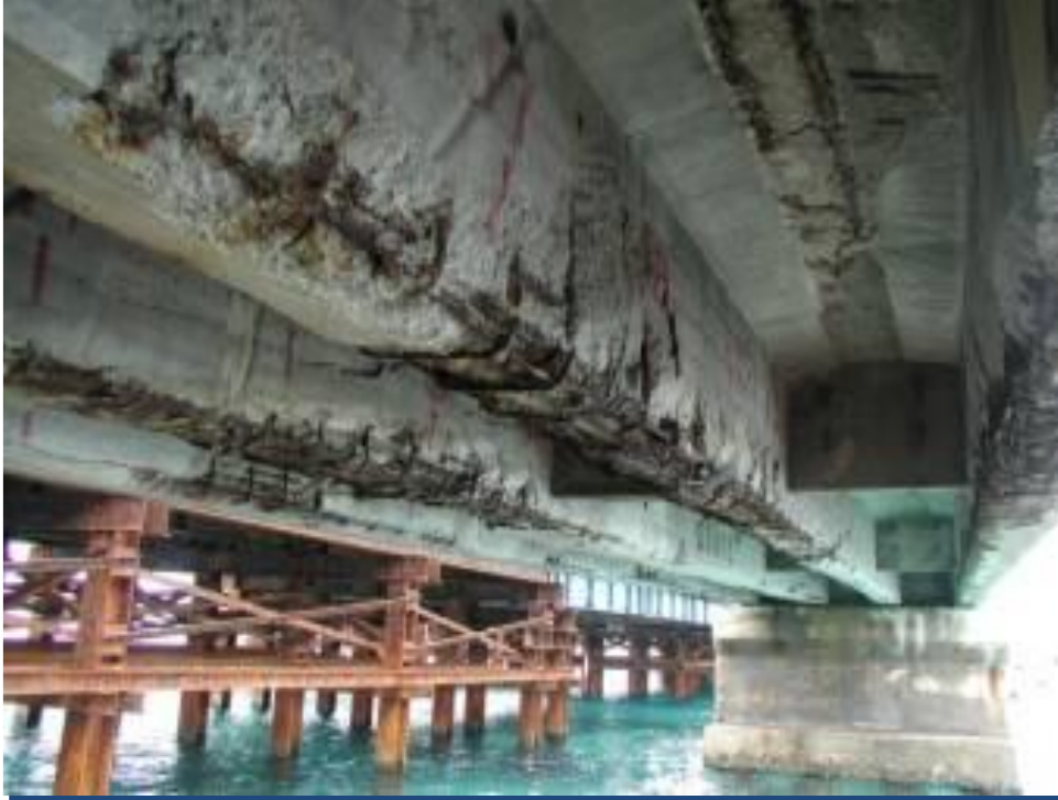
塩害による鉄筋の腐食:国総研木村嘉富氏提供
