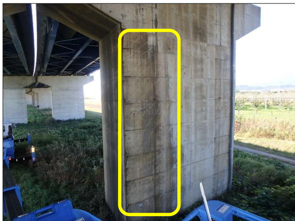
橋脚の水跡部に ひびわれ、剥離、うき
