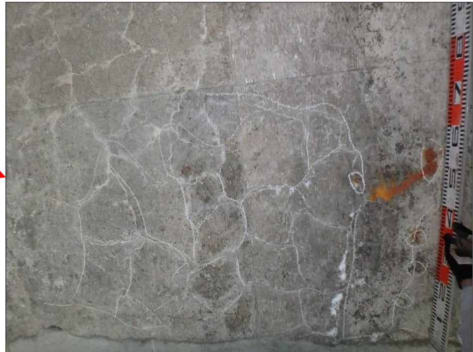
拡大写真(角落ち、錆汁)
