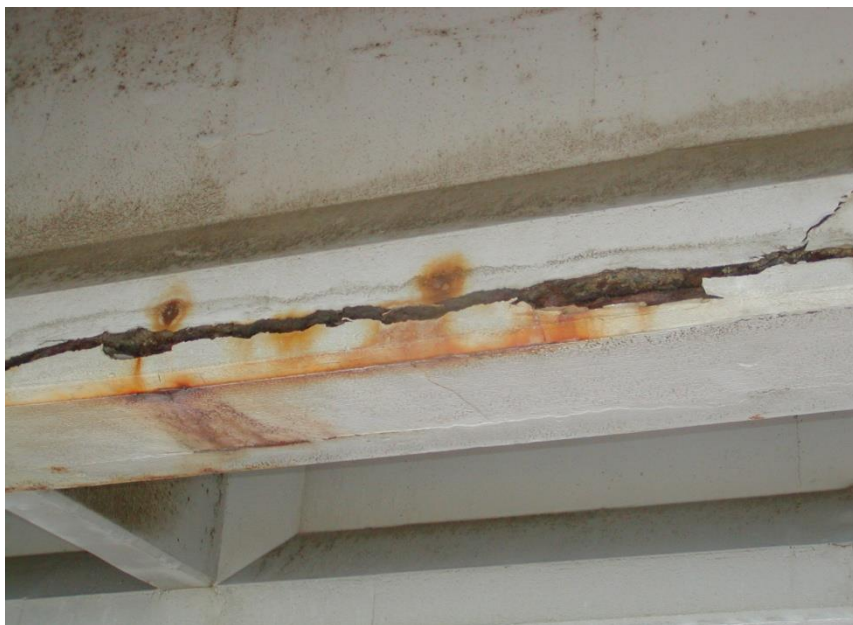
ひび割れが鋼材の軸方向に発生
