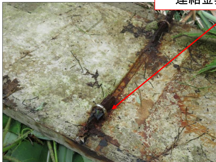
脱落した壁面パネル裏面
