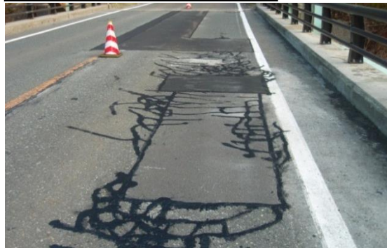
橋面舗装の補修跡
