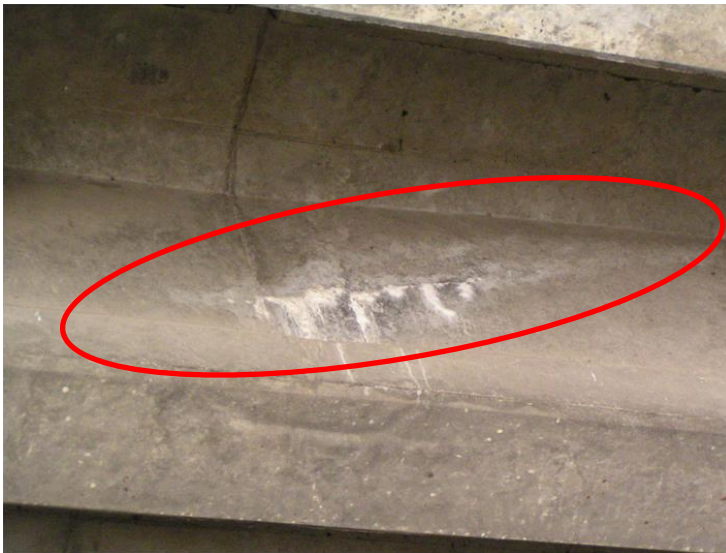
PC桁ウェブに斜め方向の ひび割れ、遊離石灰の滲出
