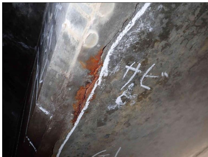
うき範囲が拡大し、新たに1.9mmのひびわれ, 錆汁の滲出が見られる
