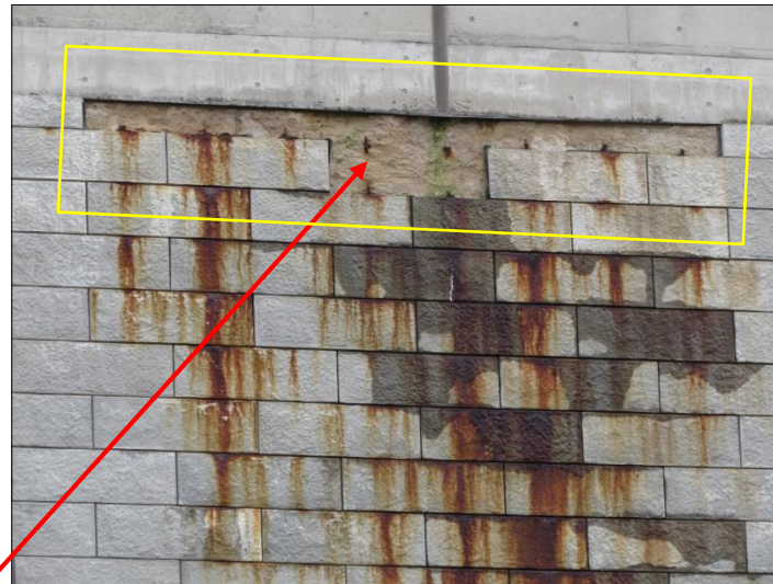
壁面パネル脱落
