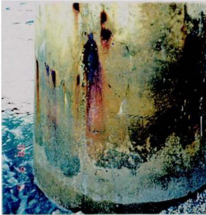
橋脚：飛来塩分による内部鉄筋 の腐食、錆汁滲出
