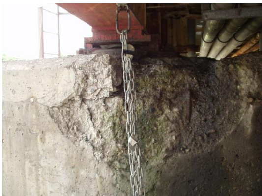
橋面からの漏水による 橋脚天端のコンクリート欠損
