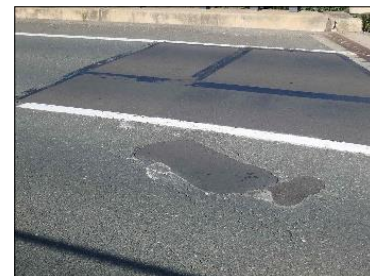
舗装開削前 土砂噴出状況
