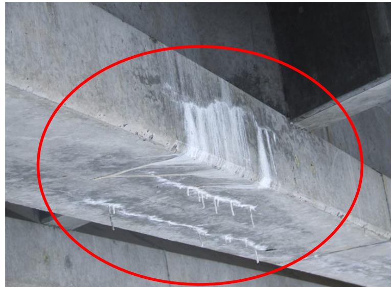
PC桁下フランジにひび割れ、 遊離石灰の滲出
