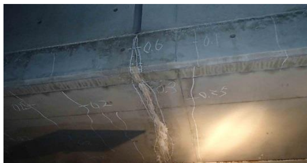
張出床版のひびわれ
