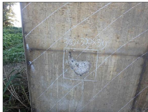
ひびわれ、剥離、うき
