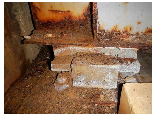
前回点検(5年前) 腐食のみ
