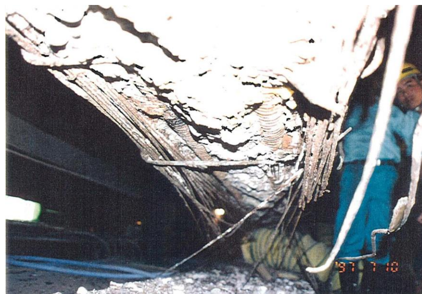
かぶりコンクリートが剥落し、 PC鋼材が破断している
