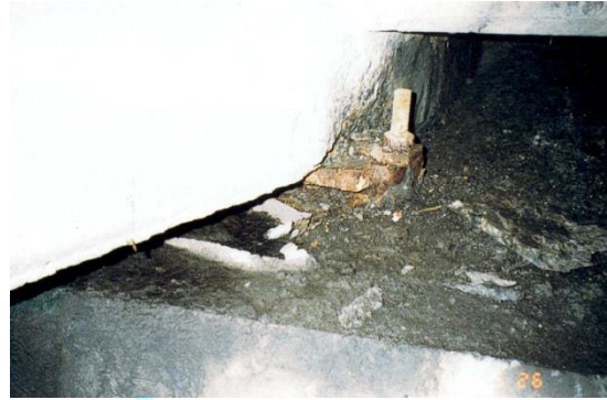
支承の腐食および土砂詰まり
