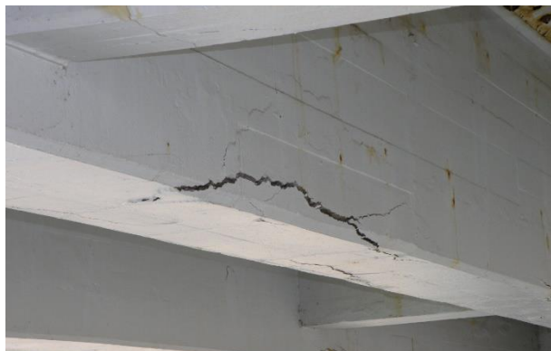
内部鉄筋の腐食によるひび割れ
