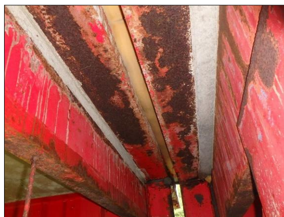
伸縮装置の漏水状況
