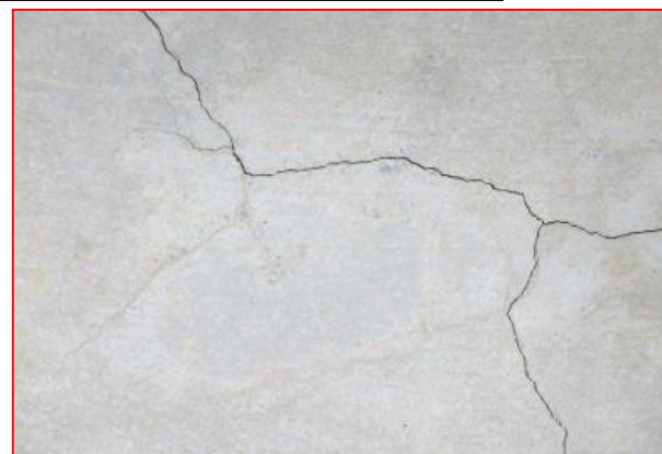
ひびわれ拡大写真
