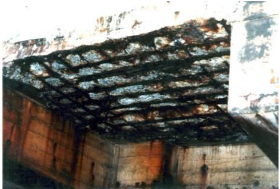
RC床版桁：飛来塩分による内部鉄筋 の腐食、コンクリート剥落
