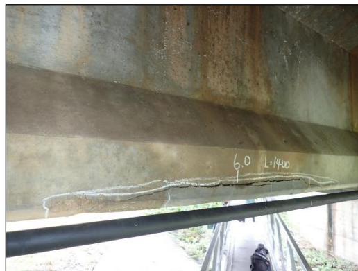
下フランジ側面の状況 (ひびわれ幅6.0mm)
