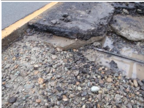
舗装、床版上面の損傷
