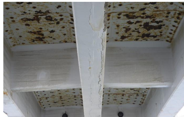
鋼板接着の腐食
