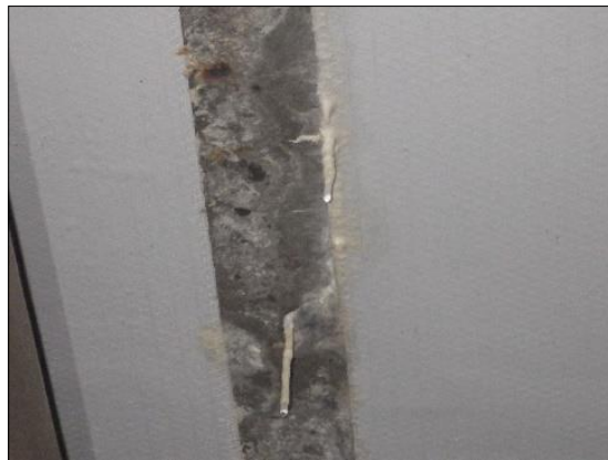
拡大写真 (つらら上の遊離石灰)
