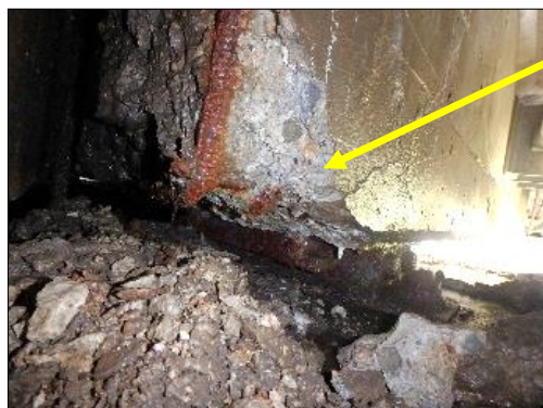
支承付近に 剥離、鉄筋露出
