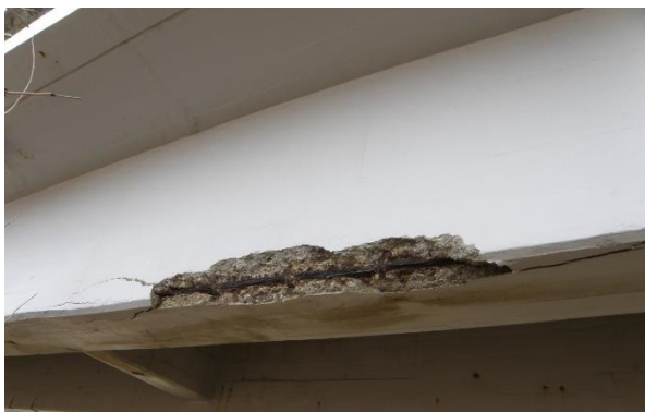
内部鉄筋の腐食によるコンクリート剥落
