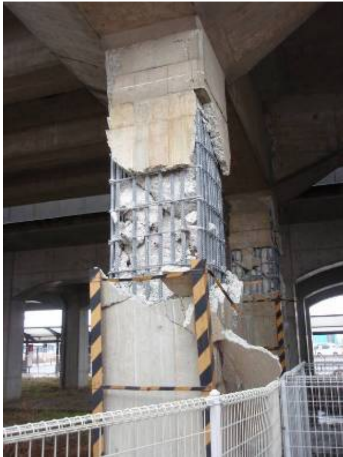
地震の揺れによる損傷
