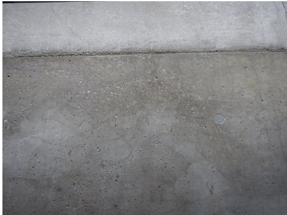
打込みリフト最上層の気泡，脆弱部
