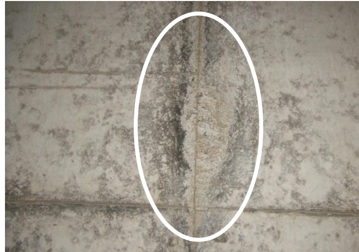
型枠継目のノロ漏れ
