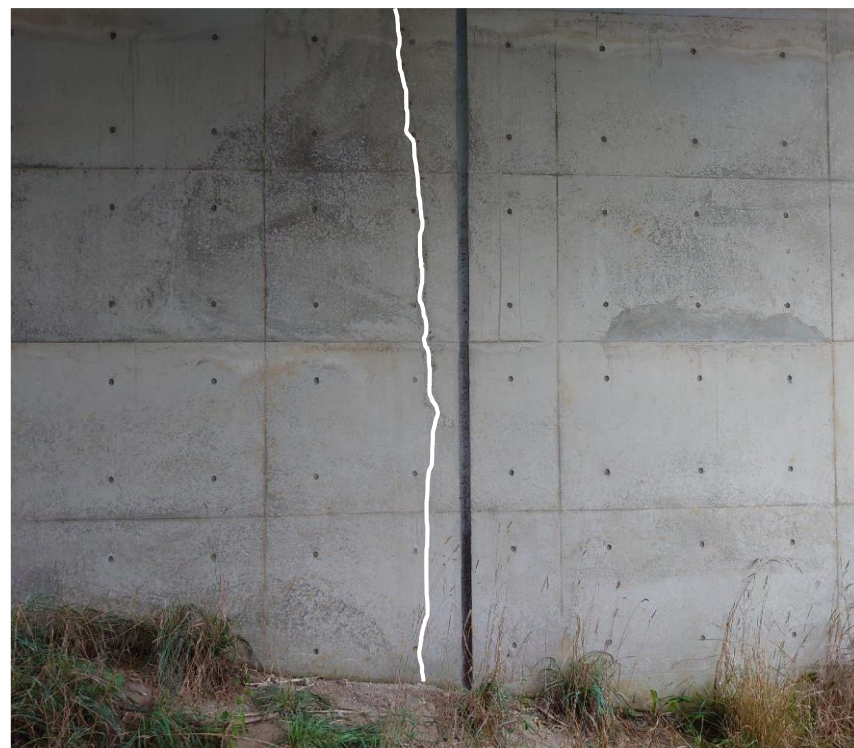
目地のそばのひび割れ (施工由来のひび割れ)
