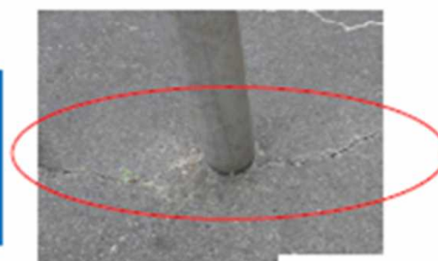
関連部位の損傷
