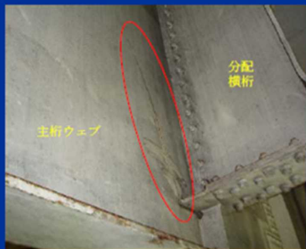
亀裂発生状況
